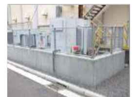
【電気設備の防潮堤】
