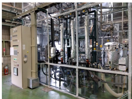
ガス分離装置ベンチ試験装置
